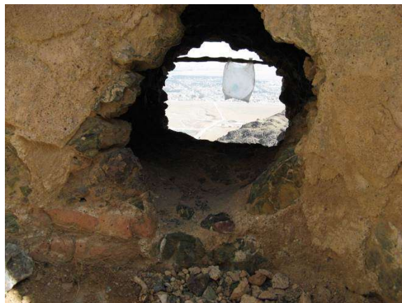
تصویر ۱: سوراخ ایجادشده در باروی قلعه و دیوار حوض که بنا به نقل قول‌ها مربوط به تخلیه آب حوض انبار می‌باشد. (نگارندگان، تاریخ ۱۳۸۷)
